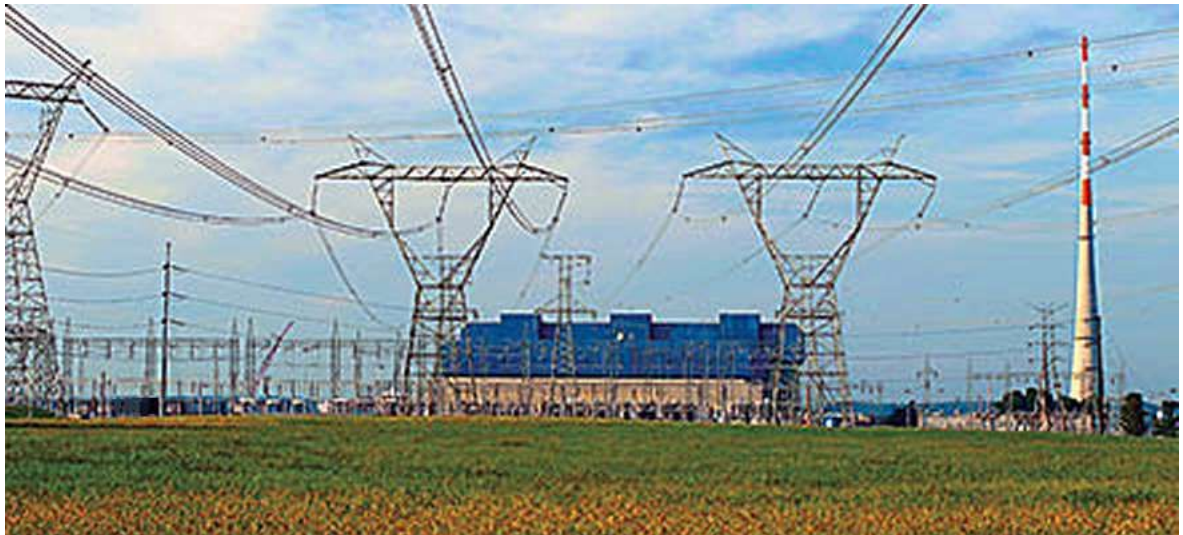
Fot1 Napowietrzna rozdzielnia i linie wysokich napięć (most energetyczny), łączące amerykańską EJ Browns Ferry 1 z systemem elektroenergetycznym
