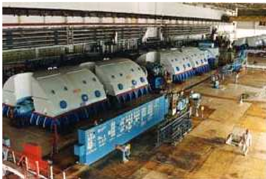
Rys. 3. Widok turbogeneratora CEA od strony przeciwnej do generatora ( http://dvoika.net/rbmk/ )
